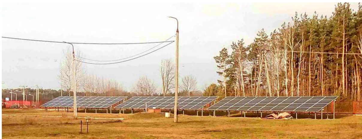
Ryc. Panele fotowoltaiczne na Stacji Uzdatniania Wody w Chorzelach, źródło: Urząd Miasta i Gminy w Chorzelach
