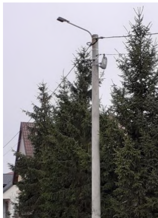
Ryc. Oświetlenie przy ul. Stanisława Komosińskiego w Chorzelach źródło: Urząd Miasta i Gminy w Chorzelach
