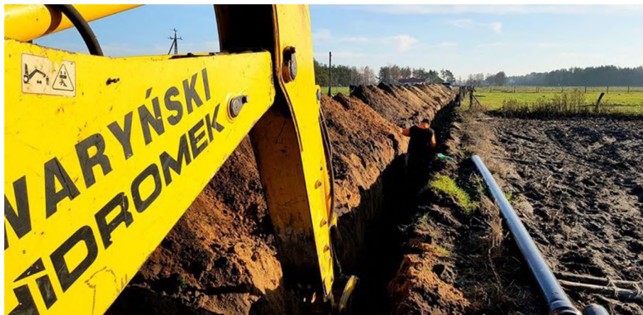
Ryc. Budowa wodociągu w Krukowie, źródło: Urząd Miasta i Gminy w Chorzelach
