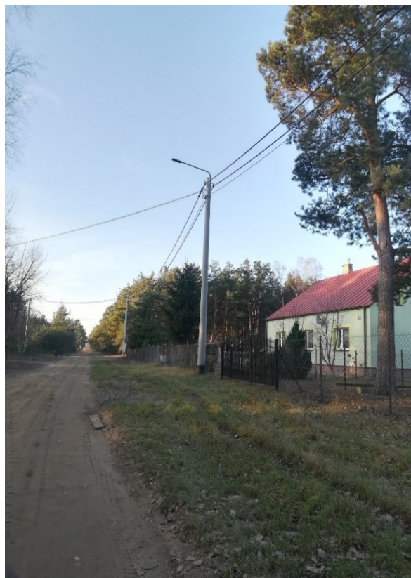
Ryc. Lampa oświetlenia ulicznego LED o mocy 50W dowieszona w miejscowości Zaręby,
