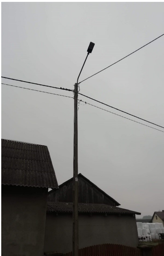
Ryc. Lampa oświetlenia ulicznego LED o mocy 50W dowieszona w miejscowości Wasiły Zygnny,
