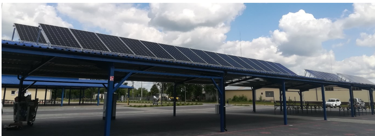
Rysunek 29 Na zdjęciu widoczne są 64 sztuki ogniw fotowoltaicznych o mocy 300W każda, zamontowane na dachu nowej wiaty znajdującej się na targowisku miejskim „Mój Rynek” w Chorzelach, ul. Zarębska, Źródło: Urząd Miasta i Gminy w Chorzelach
