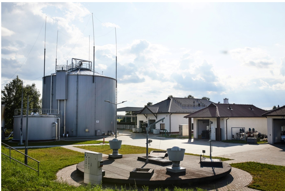
Rysunek 20 Przebudowa i rozbudowa miejskiej oczyszczalni ścieków w Chorzelach, ob. nr 8 budynek technologiczny, źródło: Urząd Miasta i Gminy w Chorzelach.
