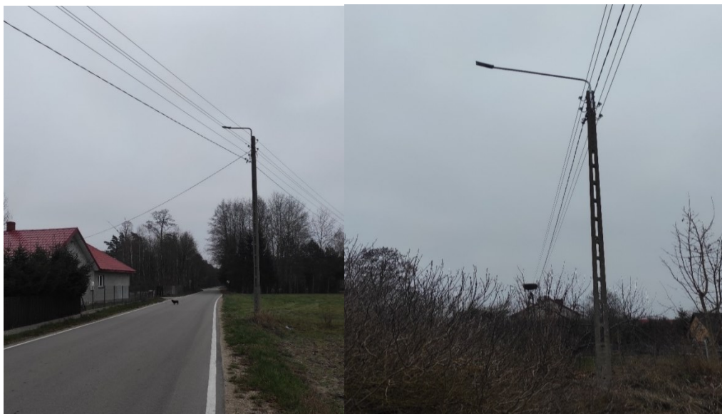
Rysunek 62 Dowieszono o oprawy oświetlenia ulicznego LED o mocy 45W w miejscowości Opalenie, Źródło: Urząd Miasta i Gminy w Chorzelach.
